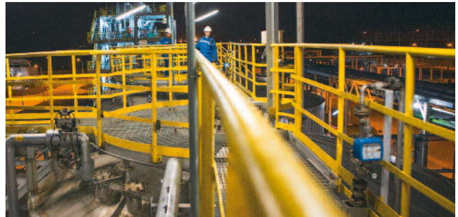
BASF • Wasseraufbereitungsanlage im Chemiewerk (Nanjing/China)
